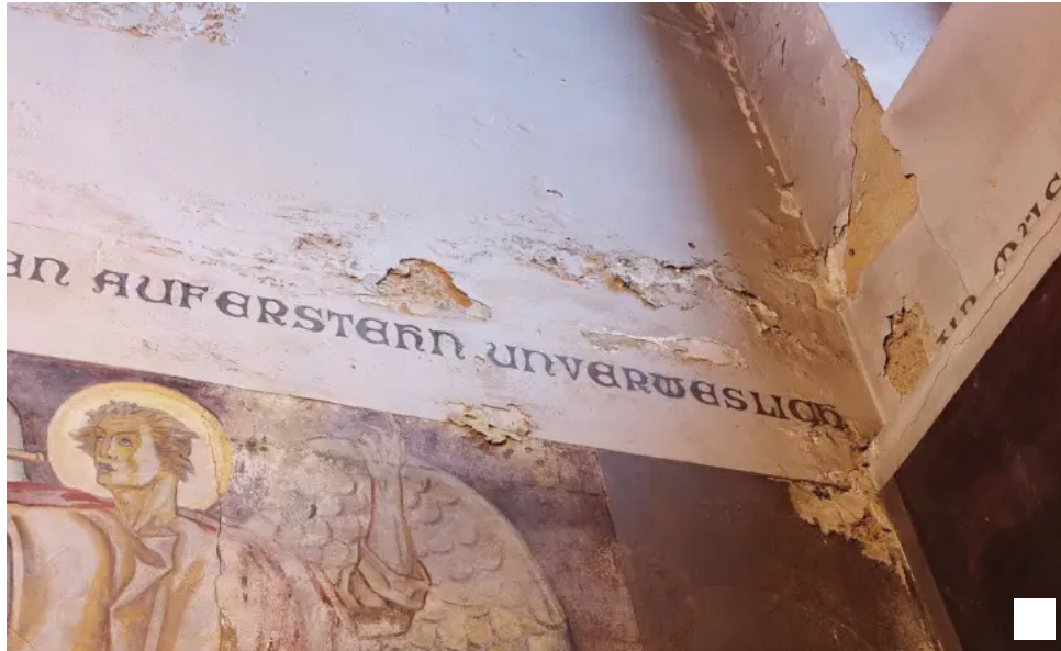
Viele Wände der Kirche haben Feuchteschäden, Putz und Farbe lösen sich. Wertvolle historische Wandmalereien sind in Gefahr. FOTO: FÖRDERVEREIN ZWÖLF SÄULEN
